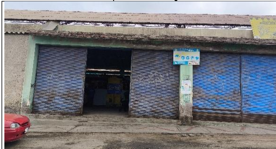
Imagen n.° 12 No existencia de rampa de acceso en el ingreso del mercado
