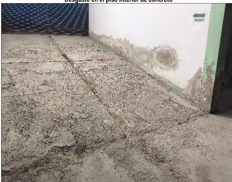
Imagen n.º 10 Desgaste en el piso interior de concreto
