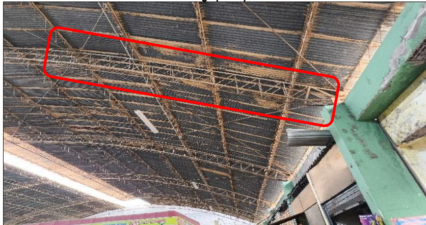
Imagen n.º 2 Corrosión de la viga principal del techo
