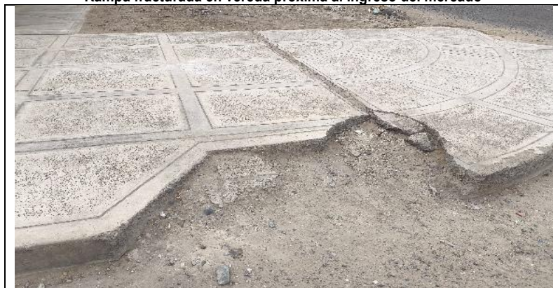
Imagen n.° 14 Rampa fracturada en vereda próxima al ingreso del mercado
