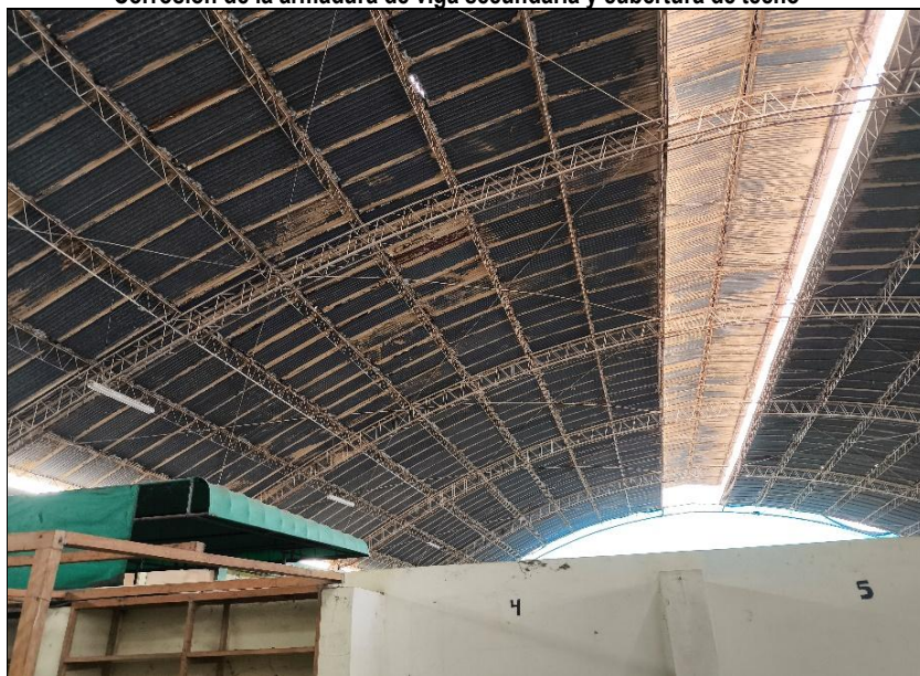
Imagen n.º 1 Corrosión de la armadura de viga secundaria y cobertura de techo
