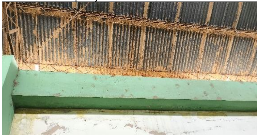
Imagen n.º 4 Soportes y cobertura de techo corroidos
