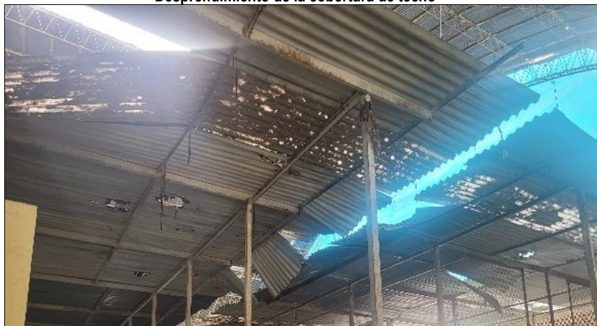
Imagen n.º 3 Desprendimiento de la cobertura de techo
