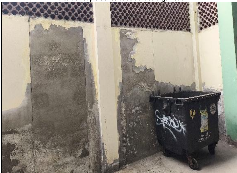
Imagen n.º 9 Deterioro de muro de concreto, desprendimiento de pintura en interior de mercado, área de acopio de residuos sólidos orgánicos
