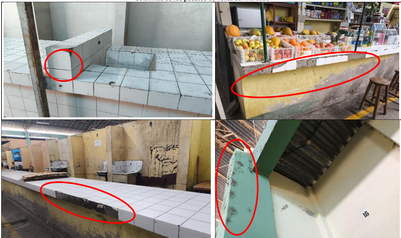
Panel fotográfico n.º 1 Desprendimiento de cerámicos en las mesadas fijas y suciedad, manchas negras en las paredes, columnas de los puestos de venta del mercado
