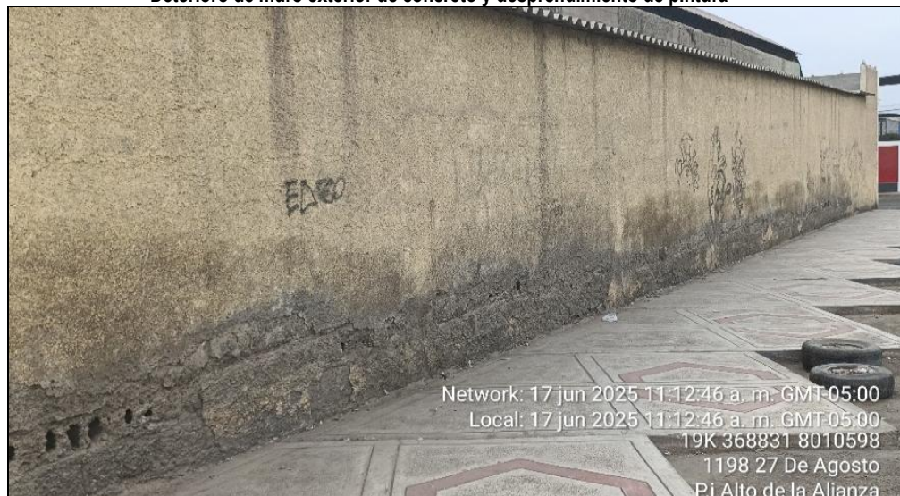
Imagen n.º 8 Deterioro de muro exterior de concreto y desprendimiento de pintura
