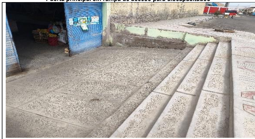
Imagen n.º 11 Puerta principal sin rampa de acceso para discapacitados
