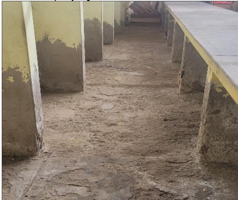
Imagen n.º 7 Deterioro de pisos y desgaste de muros de concreto en zona comercial
