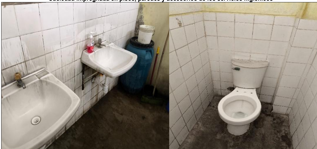
Panel fotográfico n.º 2 Suciedad impregnada en pisos, paredes y accesorios de los servicios higiénicos
