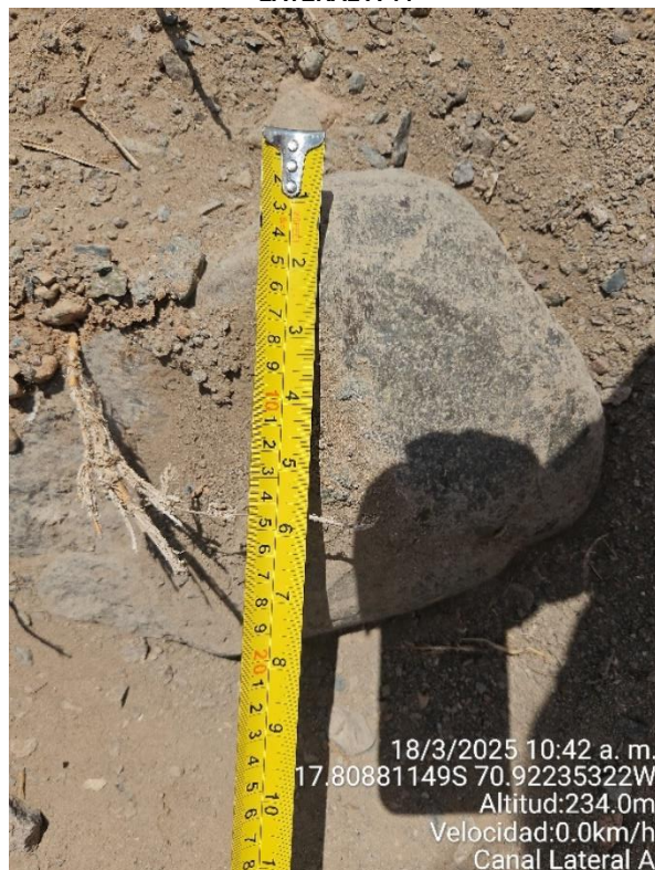
FOTOGRAFÍA N° 4 PIEDRA DE 8" UTILIZADA COMO RELLENO EN ESPALDÓN DEL CANAL LATERAL A-14
