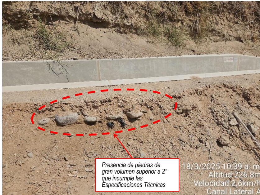
FOTOGRAFÍA N° 1 RELLENO CON MATERIAL PROPIO OBSERVADO CON PIEDRAS CON TAMAÑO >2". CANAL LATERAL A-14 PROG. 0+007
