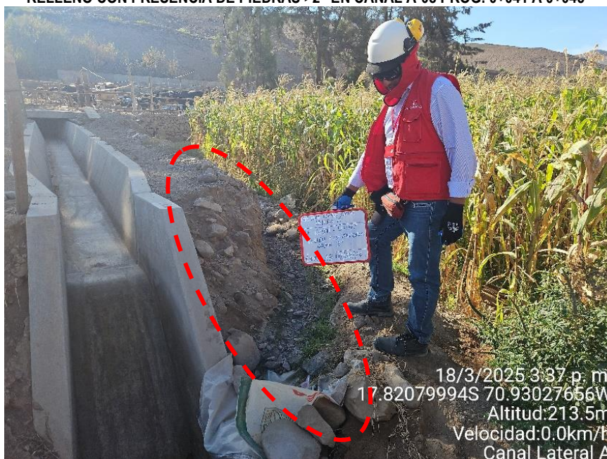
FOTOGRAFÍA N° 9 RELLENO CON PRESENCIA DE PIEDRAS >2" EN CANAL A-08 PROG. 0+041 A 0+045
