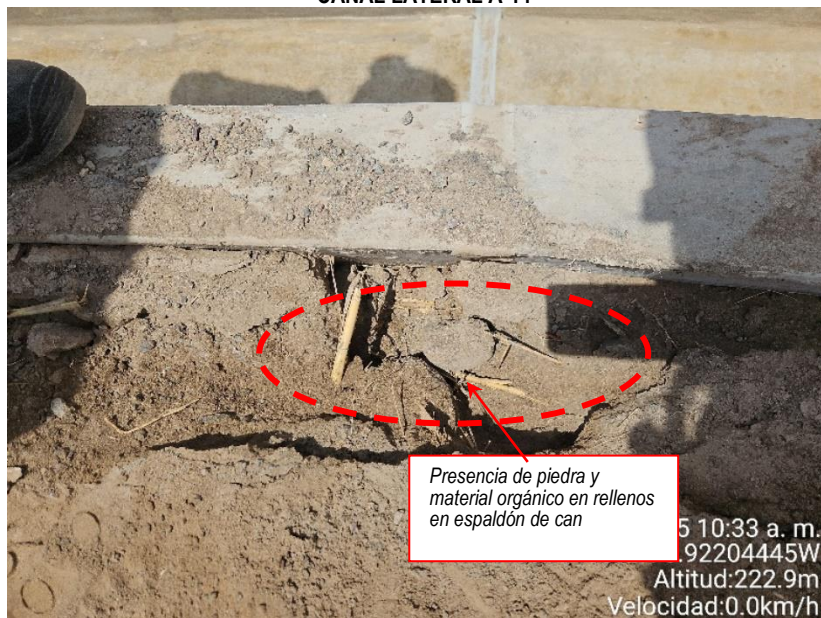
FOTOGRAFÍA N° 2 RELLENO CON MATERIAL PROPIO OBSERVADO CON PIEDRAS CON TAMAÑO >2". CANAL LATERAL A-14
