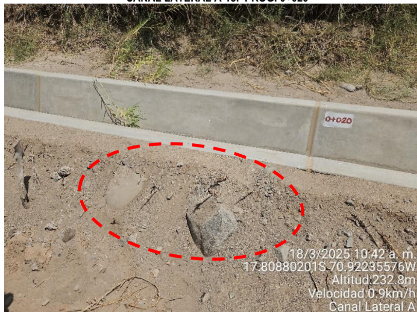
FOTOGRAFÍA N° 3 RELLENO CON MATERIAL PROPIO OBSERVADO CON PIEDRAS DE 8". CANAL LATERAL A-13. PROG. 0+020
